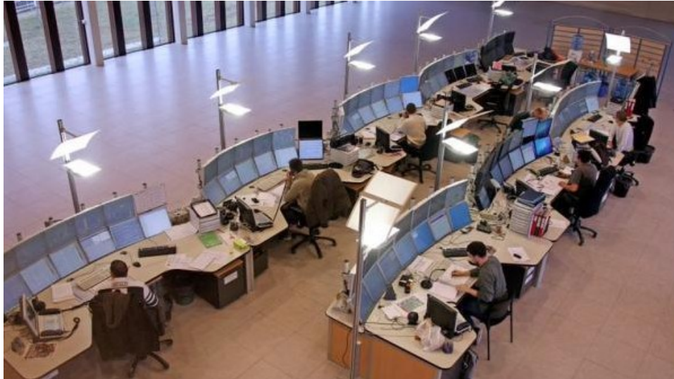
La commande centralisée du réseau Sud Lyonnais est installée près de la halte ferroviaire Jean Macé à Lyon.
