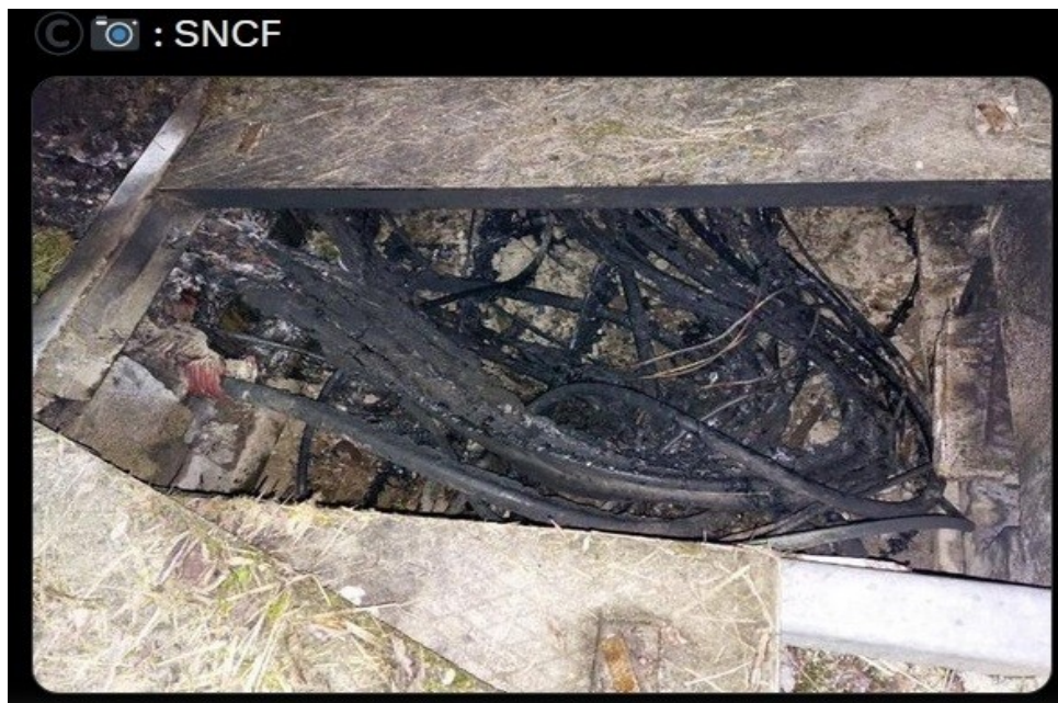
Dégâts à Vaires-sur-Marne le 24 janvier 2023 (©SNCF)
